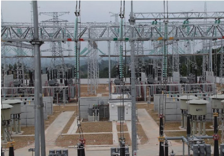
乐东望楼220KV 变电架构
